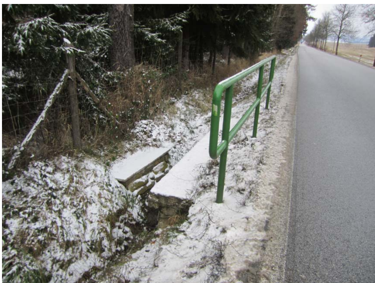
Obrázek 8: Místa s nedostatečnou ochranou odvodňovacího zařízení (vlevo v km 19,62, vpravo v km 19,73).
