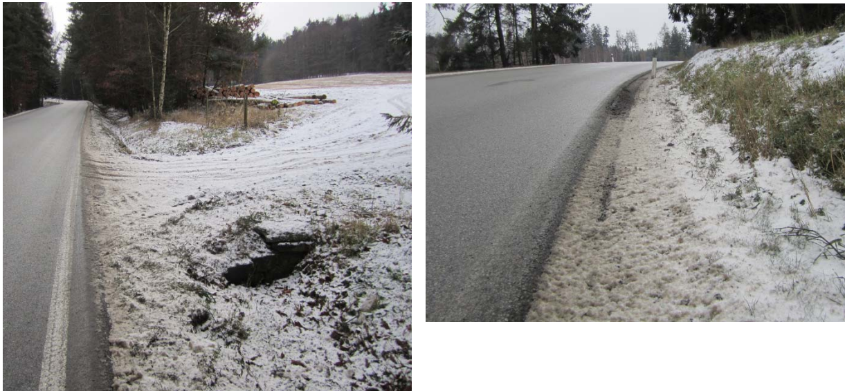
Obrázek 13: Nedostatečná hloubka odvodňovacího zařízení.
