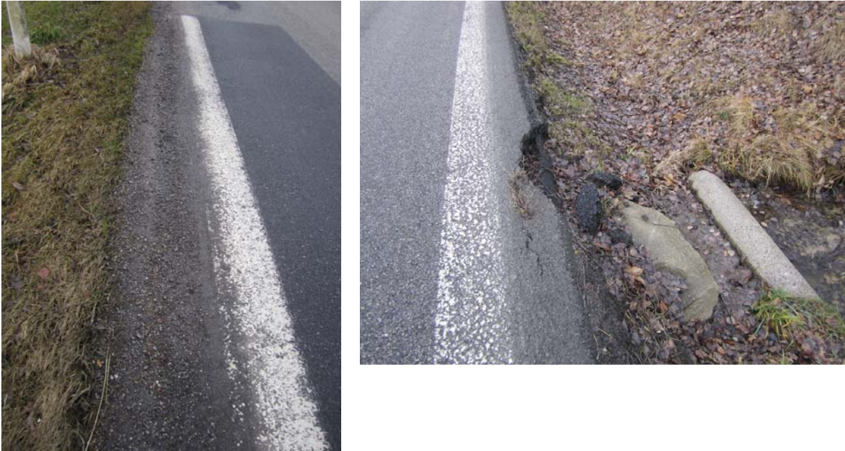
Obrázek 6: Příklady míst s nevyhovující krajnicí.
