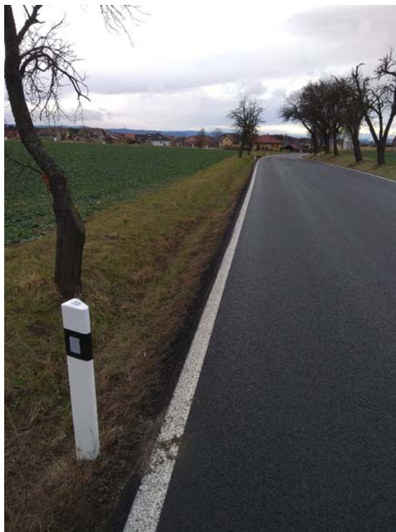
Obrázek 6: Příklad nedostatečné šířky nezpevněné krajnice.
