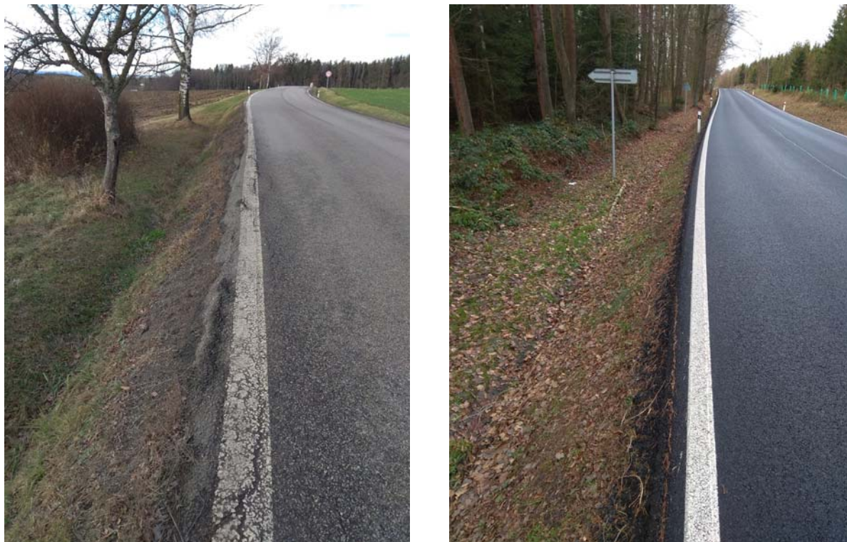
Obrázek 14: Ukázky nesprávného provedení / absence nezpevněné krajnice
