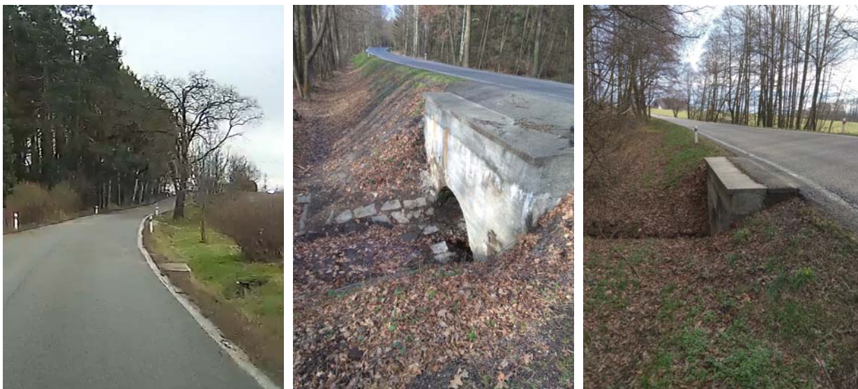
Obrázek 7: Boky čel propustků, vpravo čelo propustku v km 44,09, vprostřed – čelo vlevo km 44,67- pohled ve směru staničení (směr Srubec), vlevo - čelo vpravo km 44,67 – pohled proti směru staničení (směr Ledenice).
