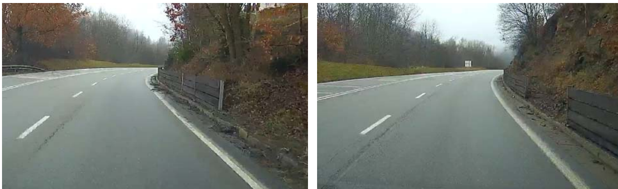
Obrázek 3: Vlevo pohled na začátek zábrany, vpravo chybějící díl zábrany
