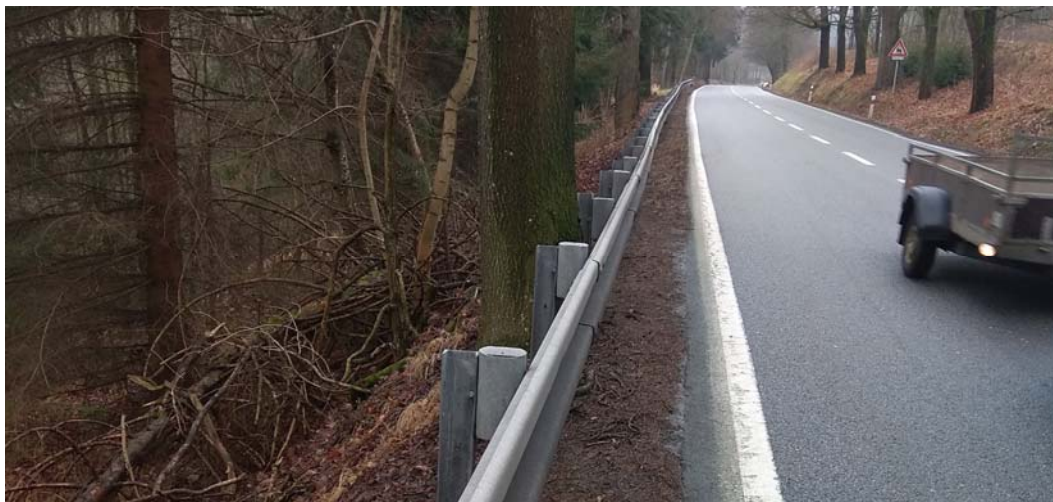
Obrázek 9: Pohled po směru staničení – stromy v deformační zóně pravostranného svodidla.
