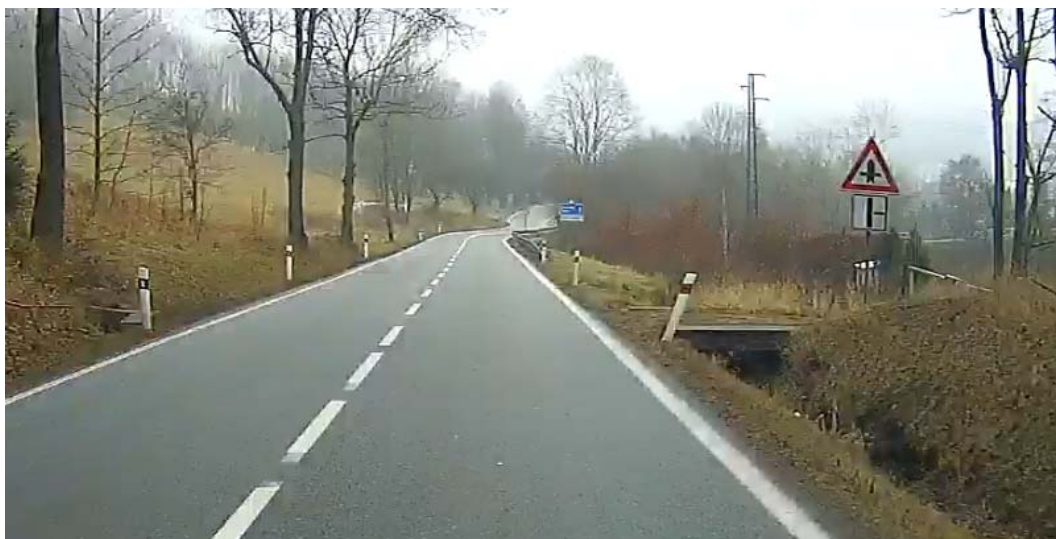
Obrázek 8: Pohled po směru staničení – konstrukce sjezdu tvoří pevnou překážku.
